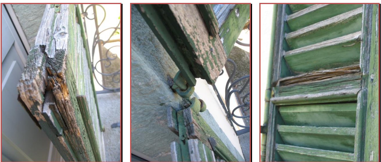
Figura 15 - Dettaglio delle patologie presenti sugli scuri del piano primo
