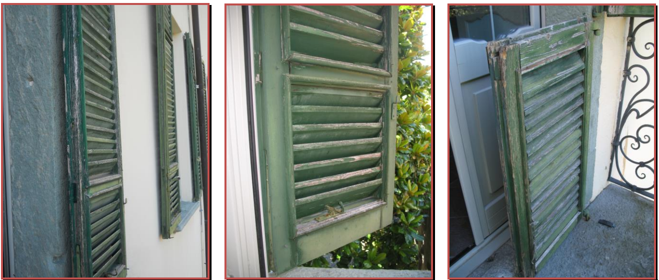
Figura 14 - Foto di dettaglio degli scuri in legno del piano primo da sostituire
